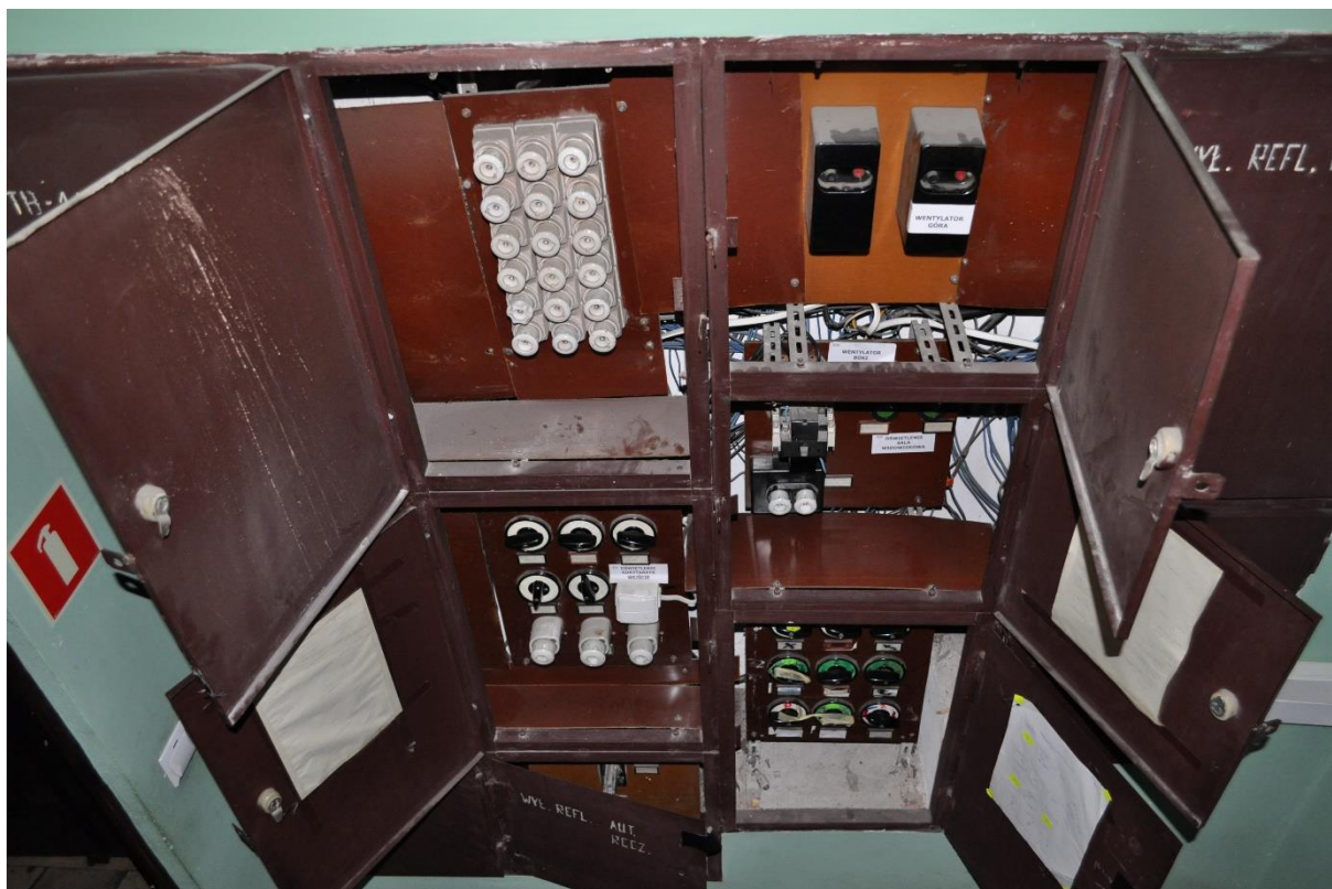
Fot. 4. Urządzenia do sterowania zasilaniem elektrycznym
